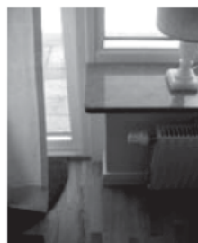
Radiatorn infälld i väggen. Den breda fönsterbänken räder över radiatorn.
