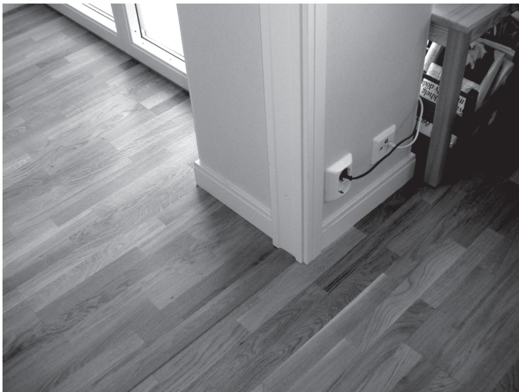
Detalj skjutdörr. De förtillverkade snickerierna var målade på fabrik och höll inte samma standard som de platsmålade snickerierna. Exempelvis så fanns i skjutdörrspartierna synliga spikskallar.
