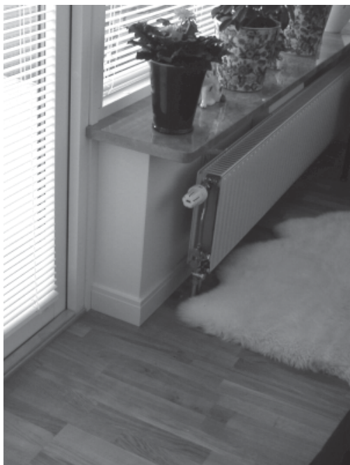
Det är många saker som påverkar möblerbarheten. En viktig detalj är nischer i väggen för radiatorerna. I Linnégården tar radiatorerna ingen plats i rummet – möblerbarheten ökar.
